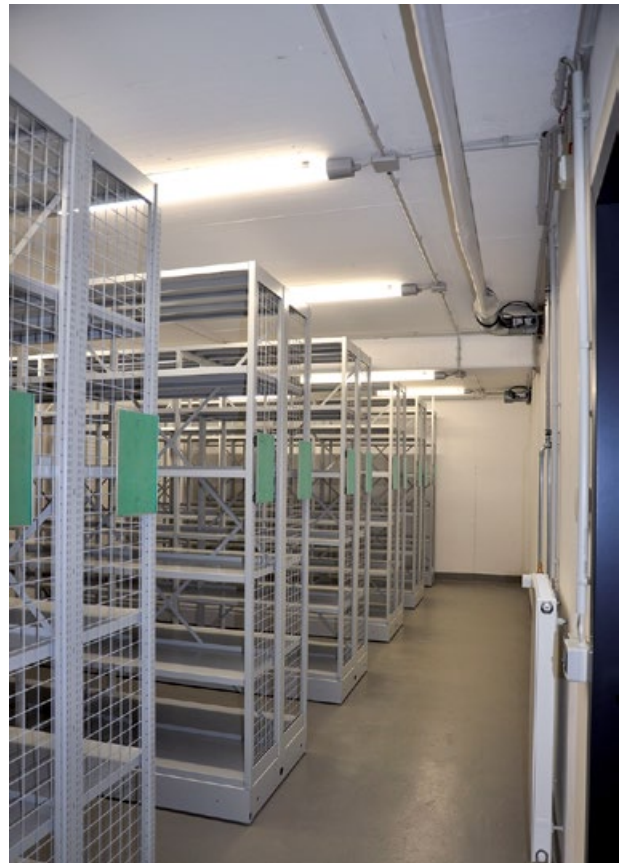
Das Quarantänemagazin im Untergeschoss des Neubaus. An der Decke ist der Textilschlauch der Zuluft erkennbar. (Foto: LWL-Archivamt)
